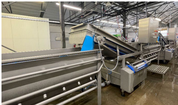
La ligne de lavage se compose d'une table de parage et de trois machines à laver GEWA 4000 B PLUS HELICAL, et a été installée dans la ligne de production.
